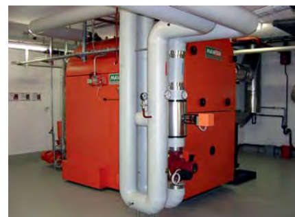
Holzschnitzelheizung produziert Energie.
