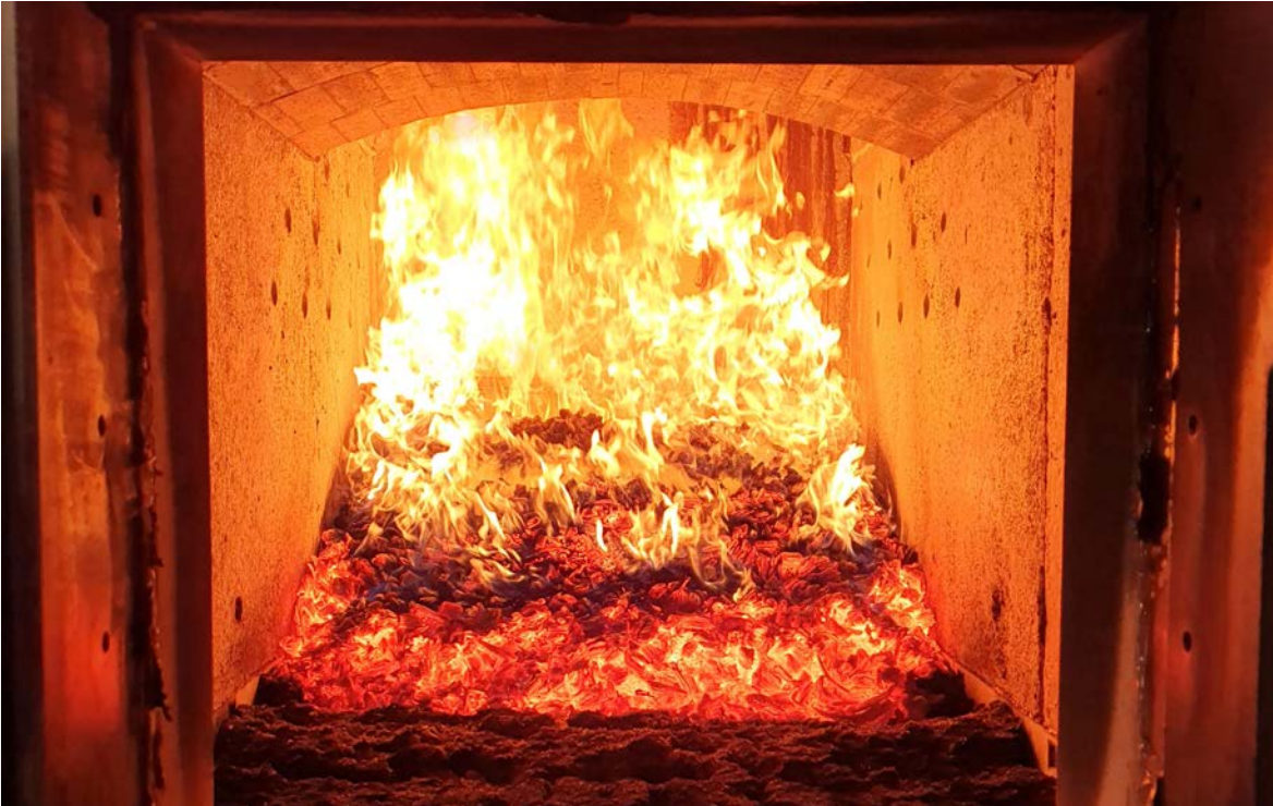
«Wärmeverbund Rothenthurm»: Einblick in den Feuerraum des Schnitzelkessels
