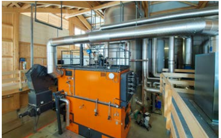
«Wärmeverbund Rothenthurm»: Der Heizkessel hat eine Leistung von 1'200 kW.
