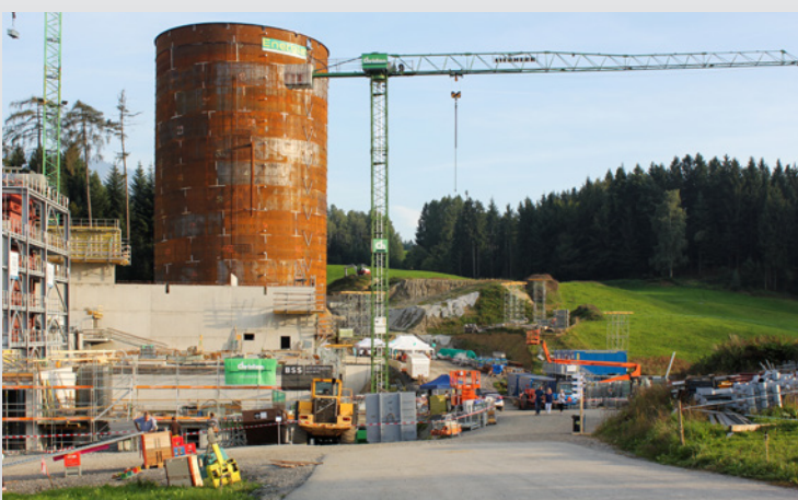
«Agro Energiezentrum Rigi AG»: Der Speicher hat ein Fassungsvermögen von 18'000 m 3 .
