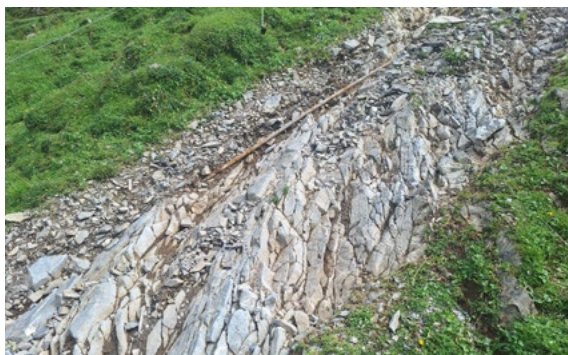
Ausgespülte Zufahrt und freigelegte Wasserleitung zur Alp Unterbäch, Stoos
