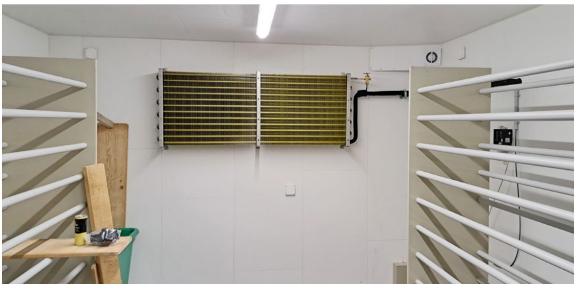
Käsekeller mit Kühlung und neuen Gestellen
