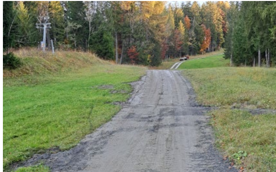
Unwetterschäden an der Strasse von der Hand zum Grossenboden
