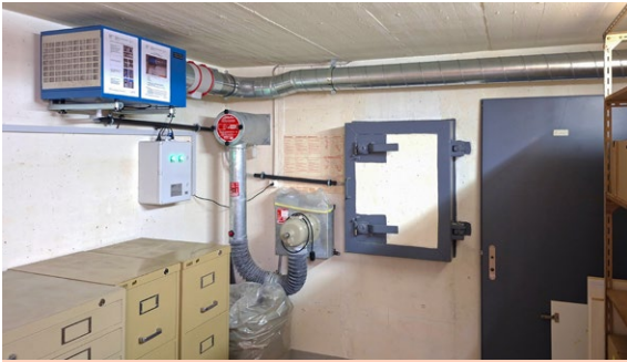
Lüftungs- und Entfeuchtungsanlage in der Zivilschutzanlage im Brühl, Schwyz
