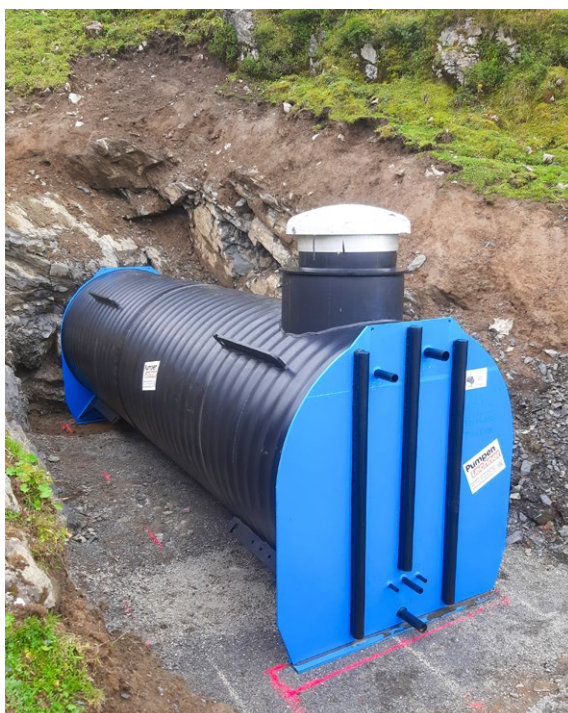
Wasserreservoir im Gebiet Spitzibüel bei der Alp Oberist Hütte, Bödmeren
